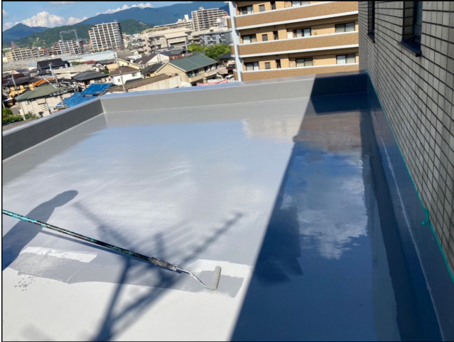
紫外線や雨風で塗膜の劣化を防止するための保護塗料を塗ります
